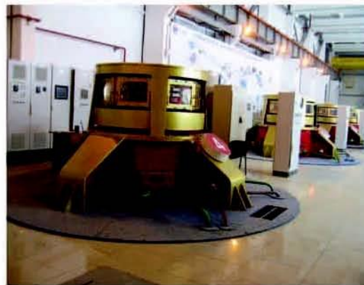
Рис.2 Егорлыкская ГЭС-2, машинный зал
